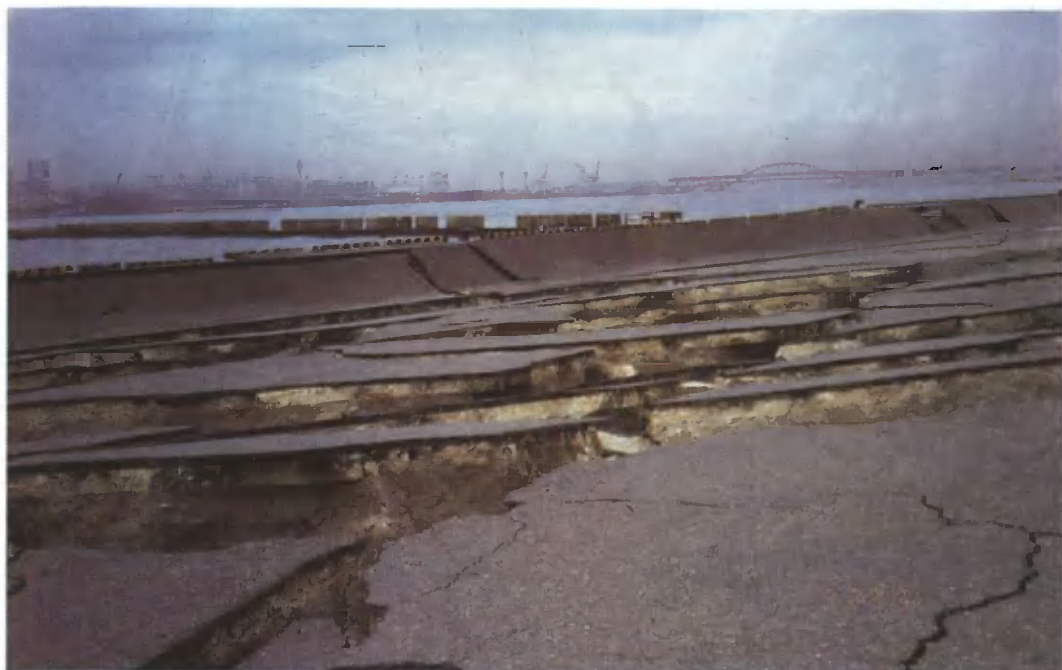
Трещины, возникшие на о. Порт-Айленд.
